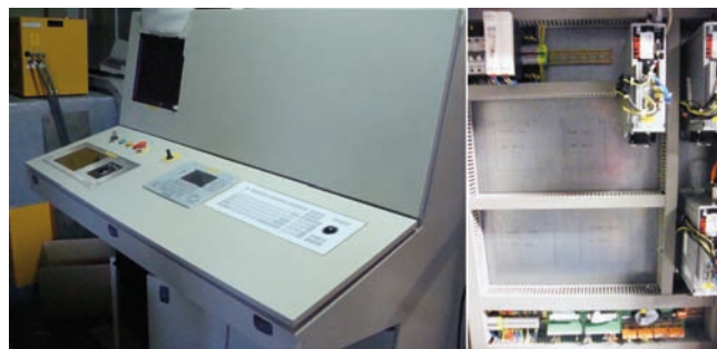
Figura 2: Consola de control (izq) y drivers de potencia y sistema de control implantados.
